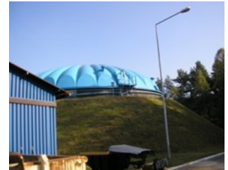
Zbiornik do stabilizacji osadów
